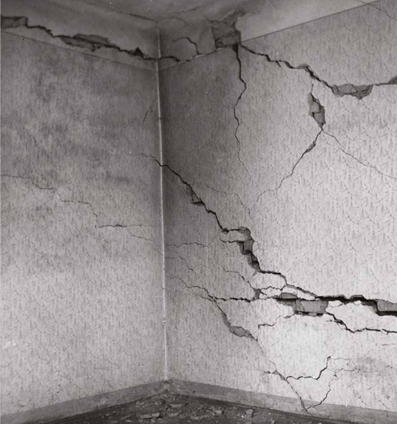
Interiér obytného domu ve Slezské Ostravě poškozeného důlními vlivy.
